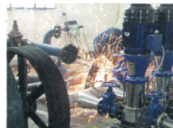
Nouvelles pompes de la centrale hydroélectrique
